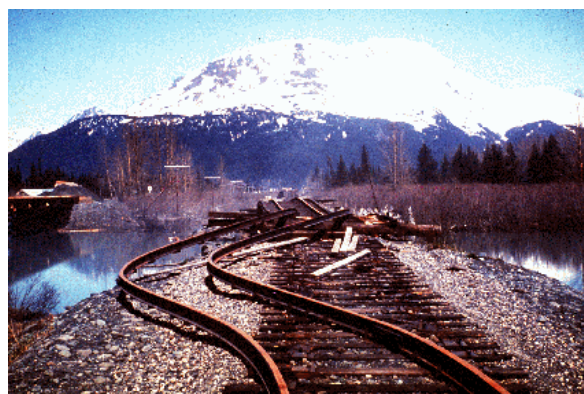
Εικ. 2.5. Βλάβες στο σιδηροδρομικό δίκτυο (σεισμός Αλάσκας 1964)
